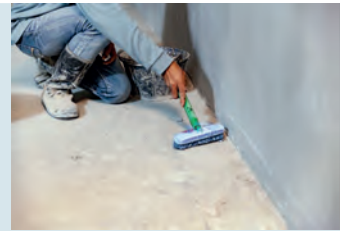
Yüzeyde kırık, bozuk bölgeler onarılmalı
